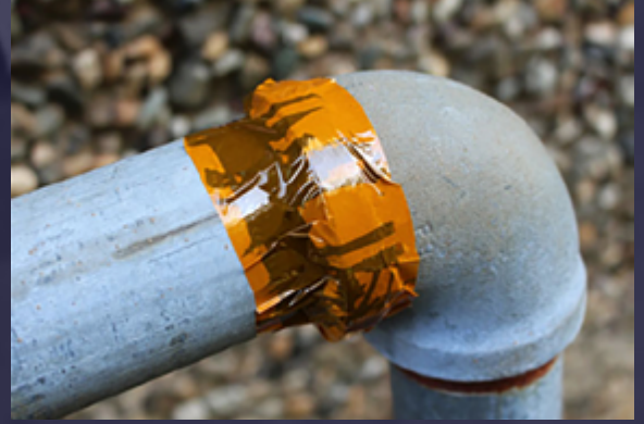
Hidrojen Sızıntı Gerçekleşmiş Uygulama
